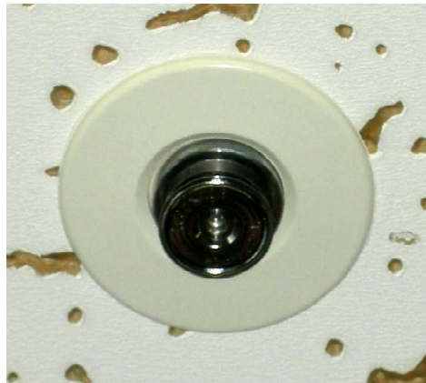
天井貼り付け参考写真
